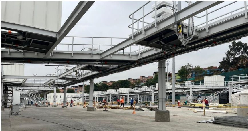
Figura 3.2: Garagem com infraestrutura de recarga aérea para ônibus elétricos “Patio Perdomo” em Bogotá, CO
